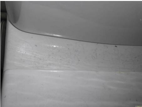
Top edge toilet bowl dirty
