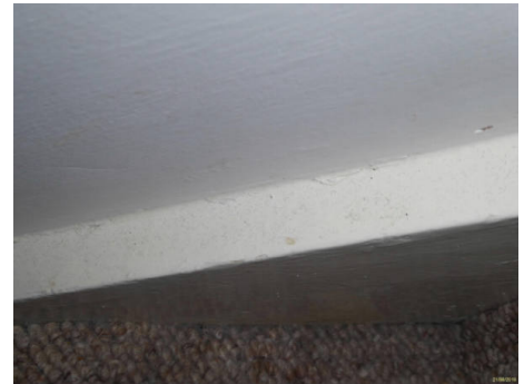
Dust top edge of skirtings
